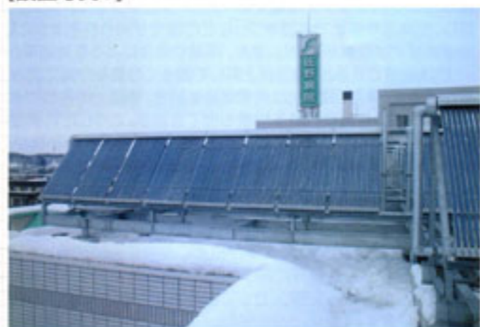
屋上に128ユニット(面)の集熱器を設置しています。
